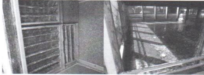
空調箱過濾網更新
